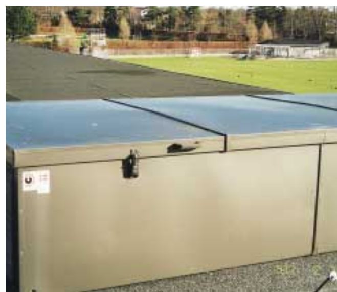
Motoren er placeret inde i ventilationsanlægget.
