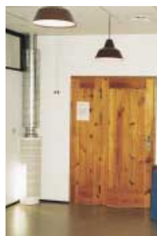
I hjørnet ses de indvendige ventilationskanaler.
