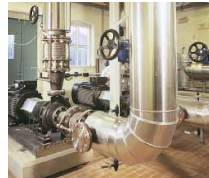
Pumperne står på et fælles fundament, der er forbundet med en betonklods med vibrationsdæmper.
