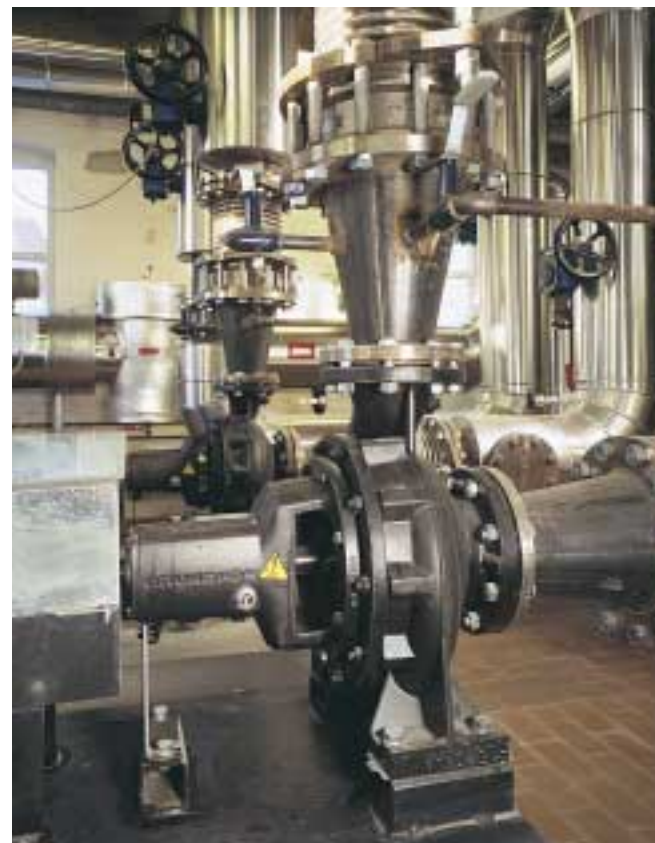
Grundfos pumperne har kørt upåklageligt døgnet rundt i godt 1/2 år.
