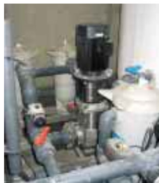
Grundfos har leveret de 18 pumper der blev brugt i 3. dome.
