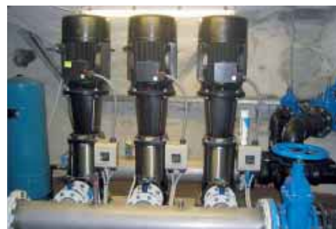
Når pumperne er i brug, er byen nærmest tømt for vand. Der pumpes 50-70 m 3 op i tårnene i timen.
